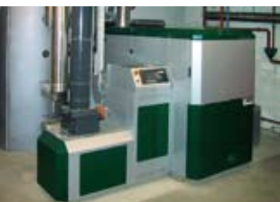
Straßenmeisterei Gloggnitz Pelletsanlage 150 kW
