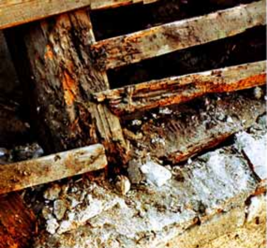
Kreuzgang, Westtrakt, Schadensbild
