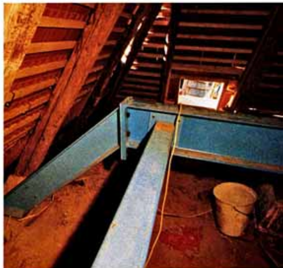
Saaldecke — statische Sicherung
