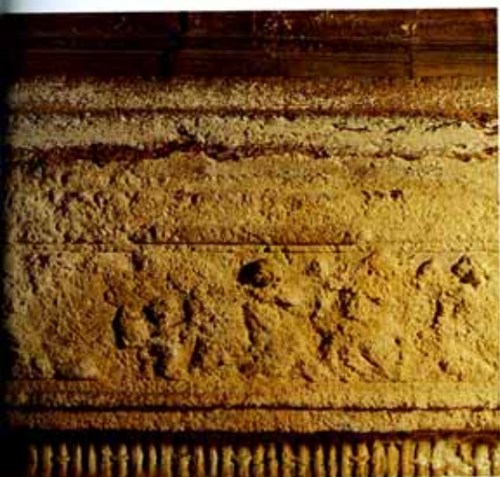
Krypta — Altarrelief (Sandstein), Schäden durch Feuchte und Mauerzsalze
