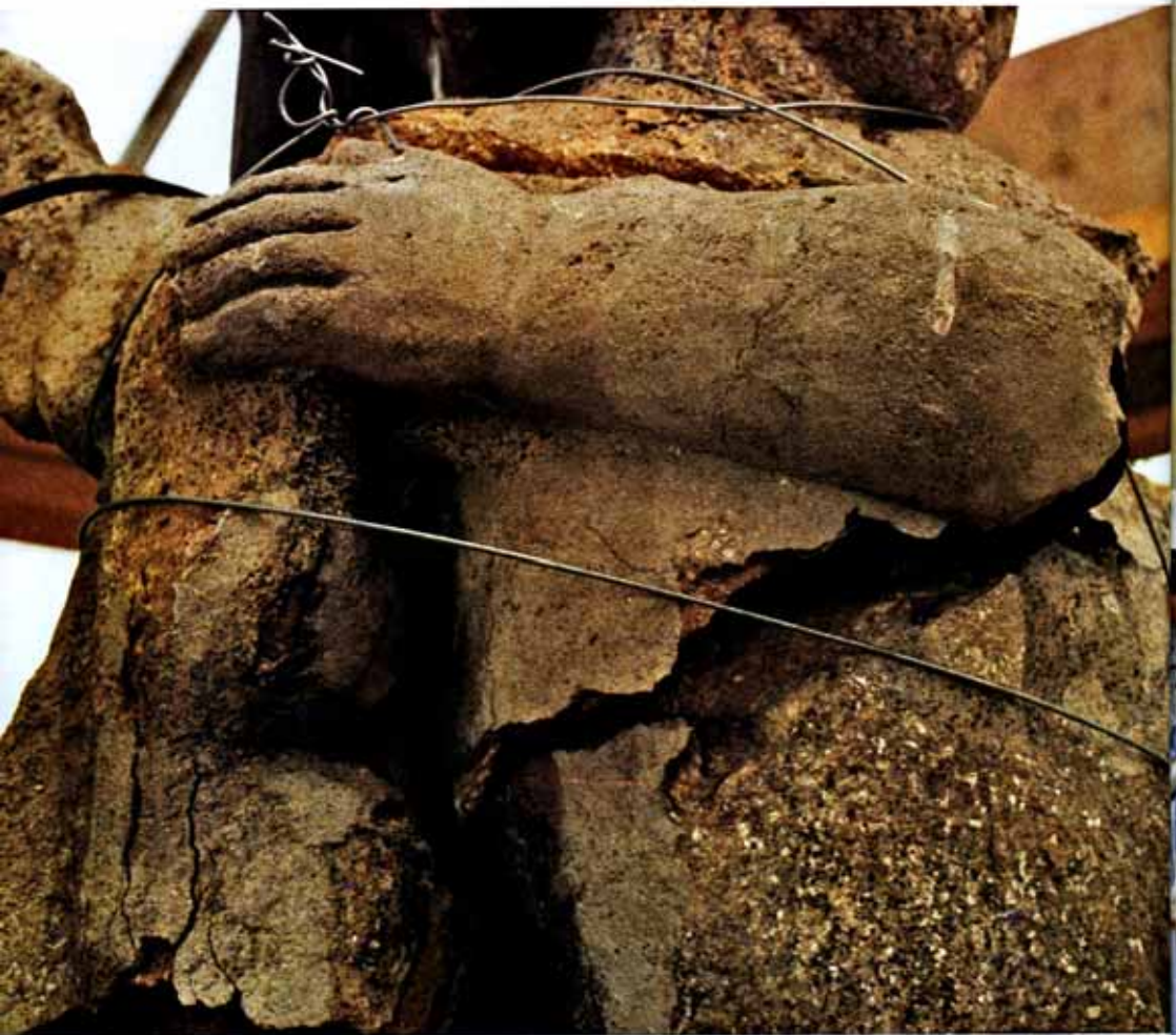
Turmhelm, östlicher Putto, Schaden 16. April 1986 (der Arm wurde 1966 falsch ergänzt)
