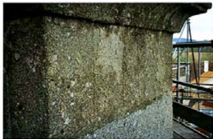
Schalenbildung an den Granitquadern; in diesem Bereich erfolgten auch diverse Probeimprägnierungen (im Foto nach feucht)
