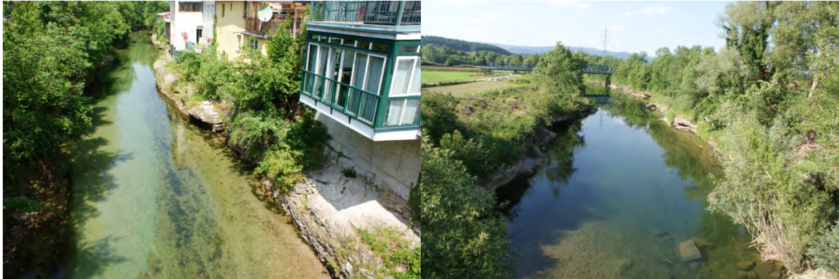
Abbildung 100: Unterspülung km 29,05 (Scheibbs)
