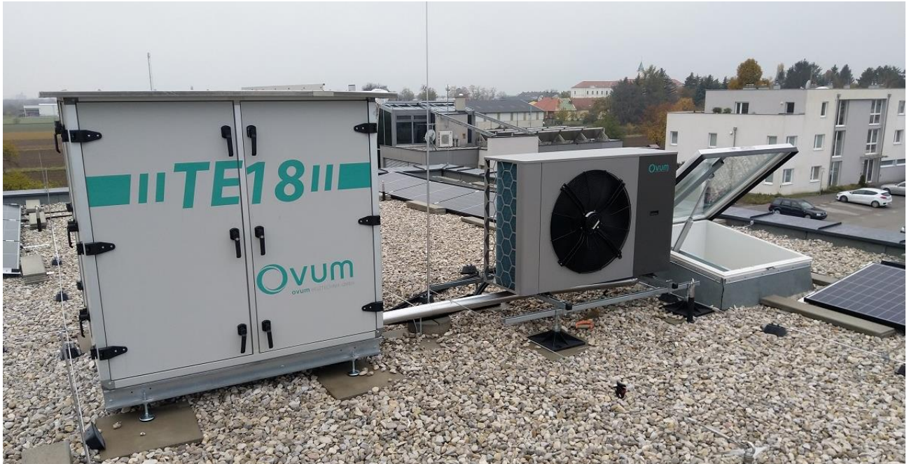
Grafik 23: Theresienfeld Tonpfeifengasse – Energiezentrale mit Wärmepumpe am Dach
